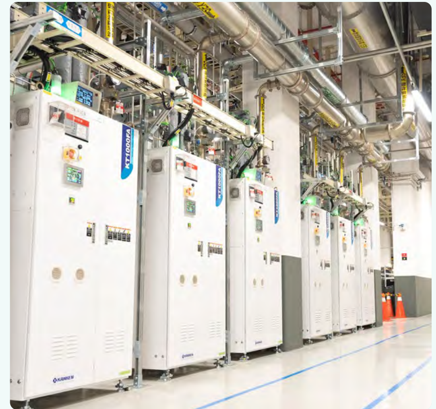
台積公司攜手供應商改造電熱式現址式處理設備，提升氧化亞氮削減率
