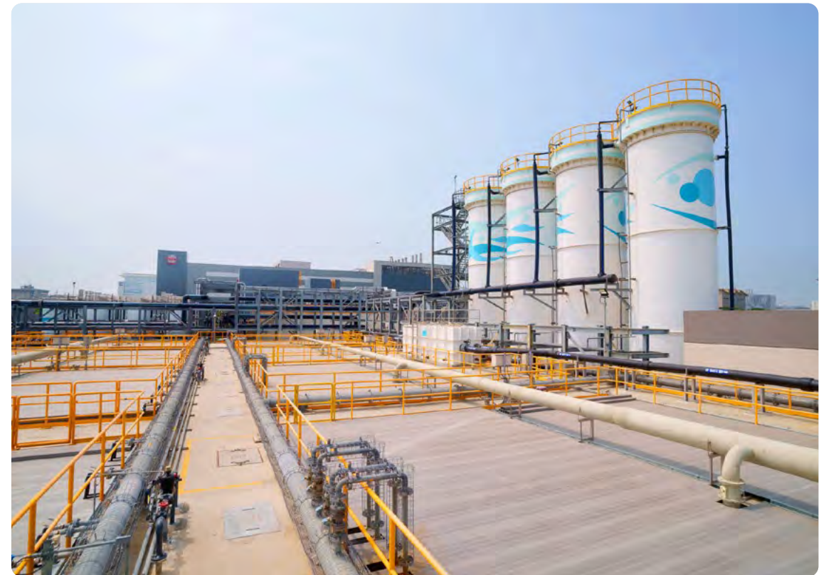
台積電南科再生水廠
